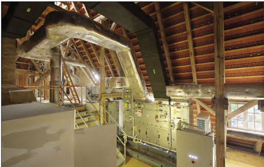
Bleibt vor den Augen der meisten Besucher verborgen: Die aufwändige Technik für die Be- und Entlüftung des Rathaussaals wurde im Dachgeschoss installiert.
