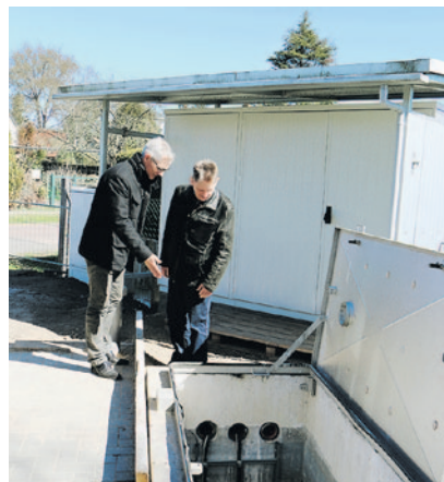
Lothar Wolf (r.) vom Eigenbetrieb Abwasser und Olaf Bennühr von der Wasser Nord begutachten das instandgesetzte Abwasserpumpwerk in Borgsdorf.
