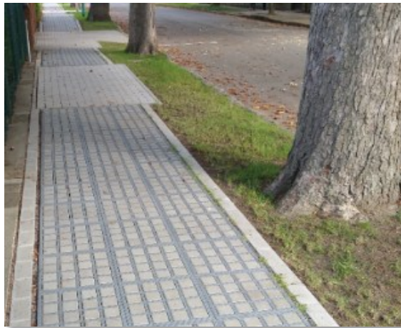
Abbildung 15: Beseitigung von Gehwegwurzelaufrüchen
