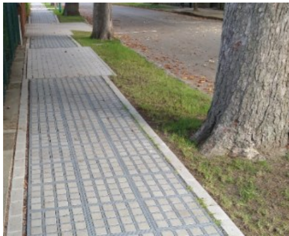
Abbildung 13: Beseitigung von Gehwegwurzelaufrüchen
